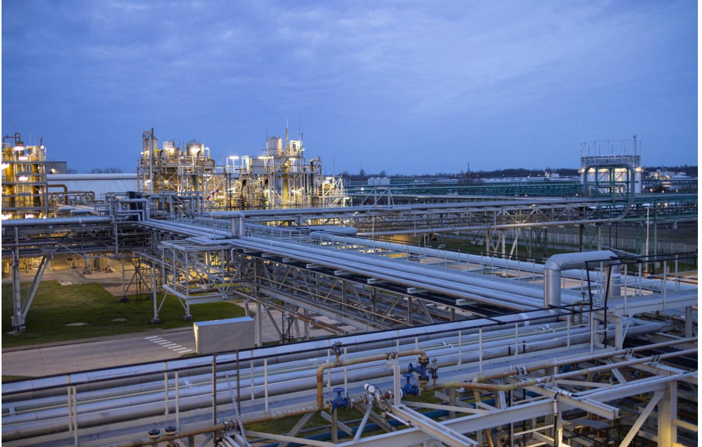
Nobians Elektrolyseanlage in Bitterfeld, Deutschland. Foto-Credit: Nobian GmbH.
